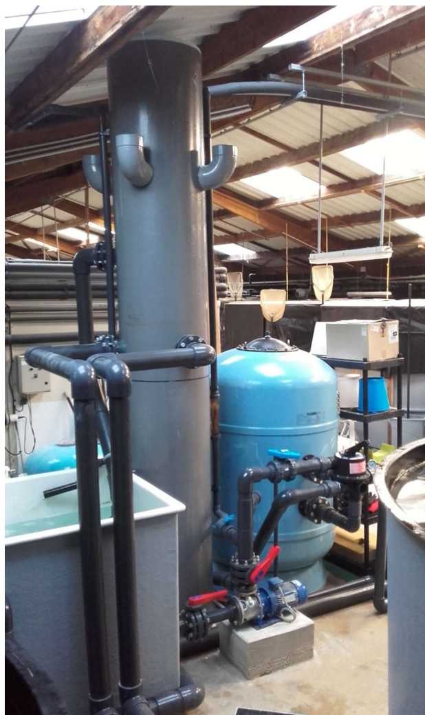
Tour de dégazage du \text{CO}_2
